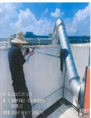
注塑废气排气筒进口 G7
