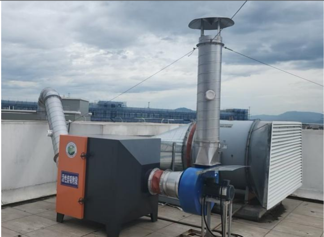
图 3-1 活性炭吸附处理设施及排气筒
