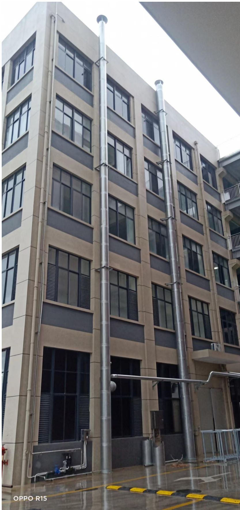
废气设施（27m高排气筒排放）
