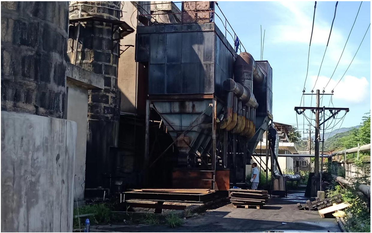
布袋除尘设施
