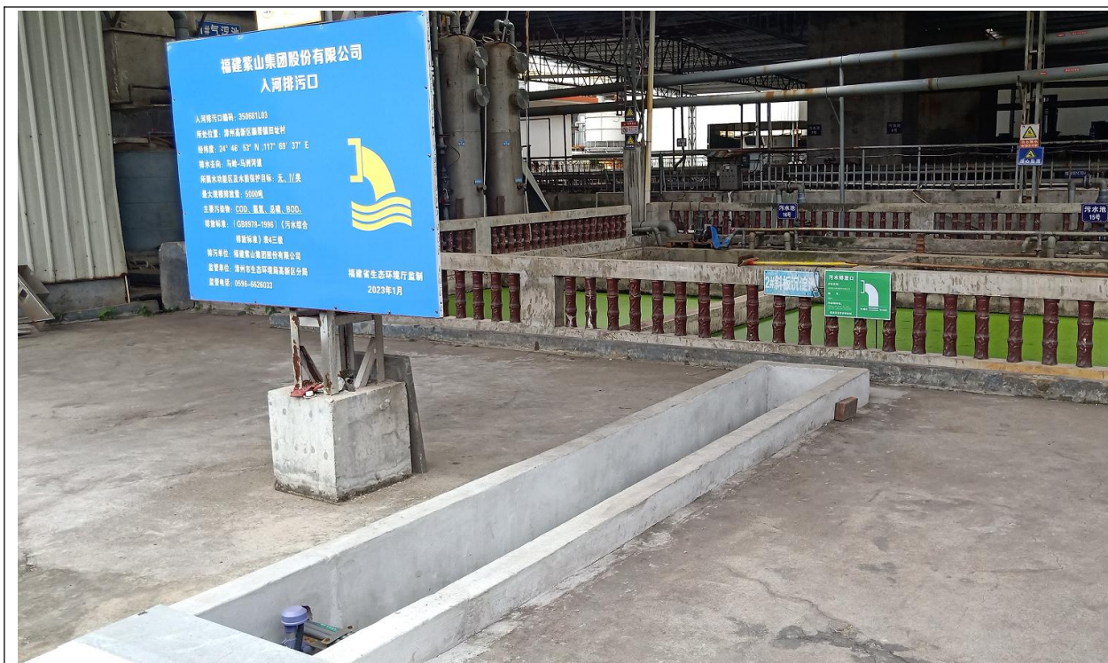
废水规范化排放口
