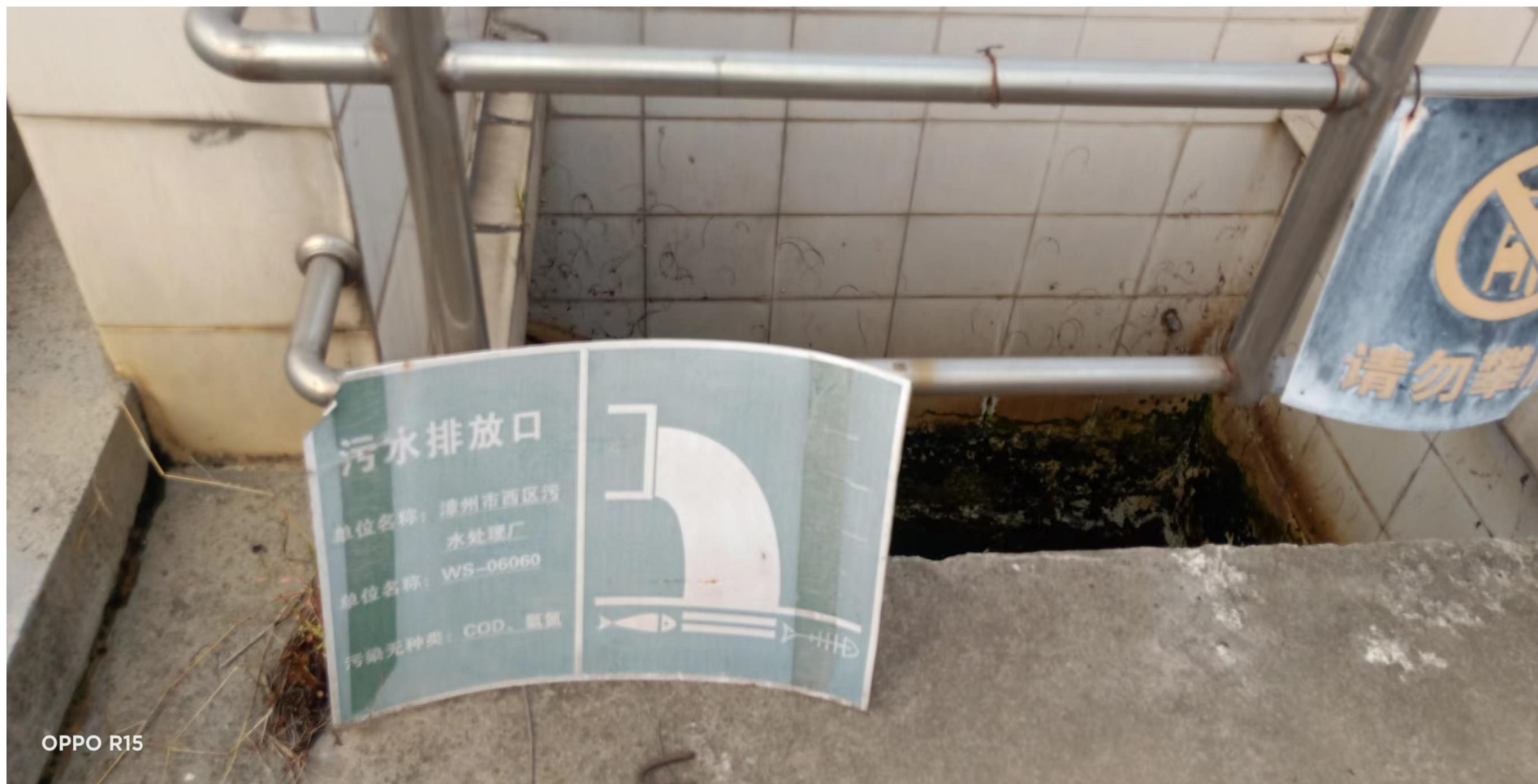
图 4-5 废水规范化排放口
