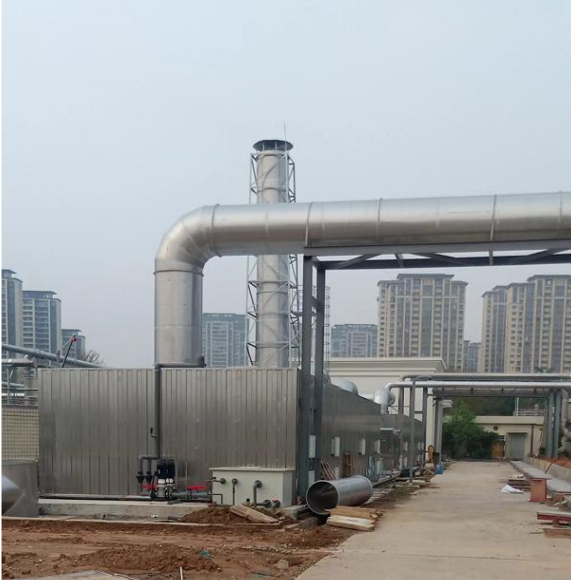
图 4-2 废气生物除臭系统装置+15m 高排气筒
