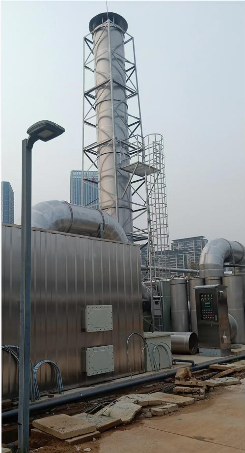
图 4-4 排气筒监测平台及通往监测平台通道、监测孔
