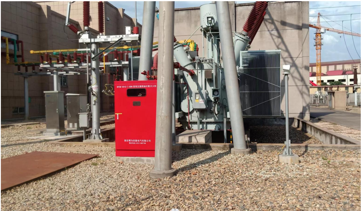
#3 主变（容量为 180MVA）
