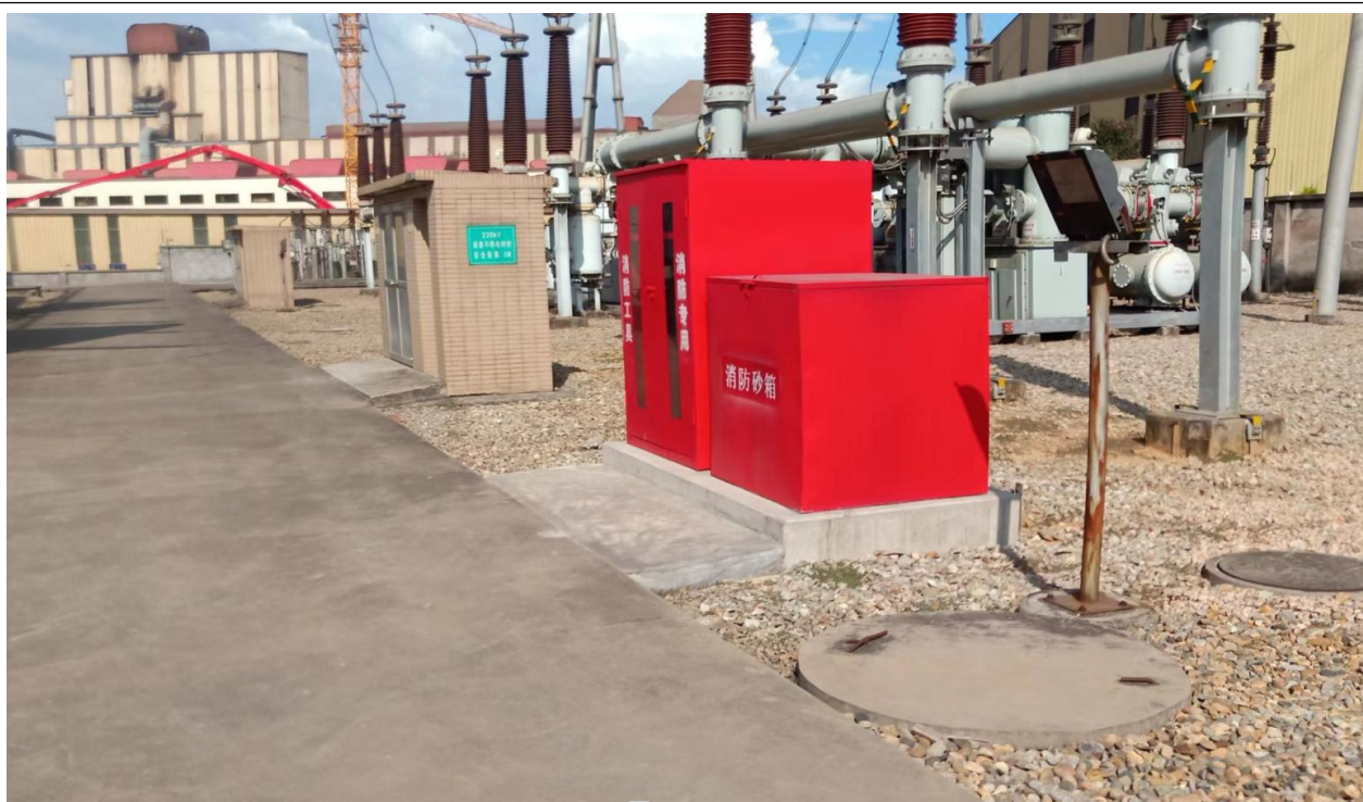
新建消防器材及消防砂箱
