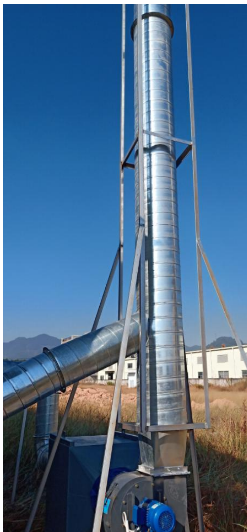
15m 高排气筒
