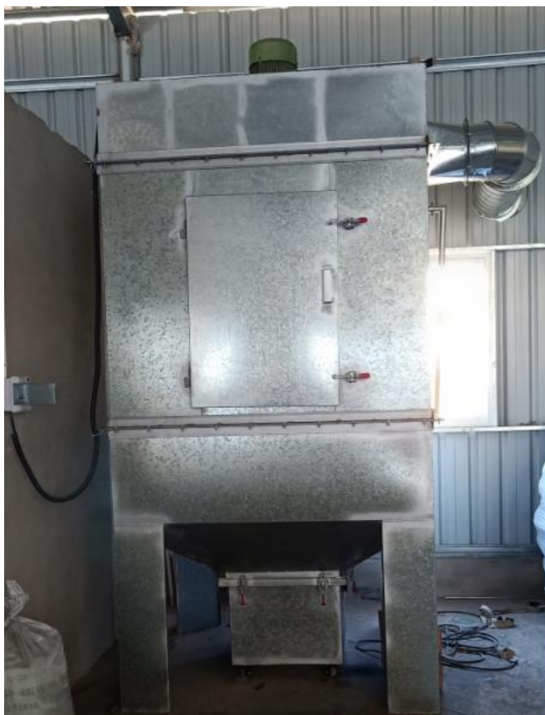
布袋除尘装置+15m 高排气筒
